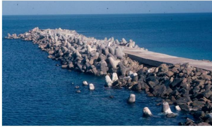
Hình 1.10 Đê chắn sóng bằng khối phủ Tetrapod bị phá hỏng ở El Kala, Algeria năm 1979 [1]
