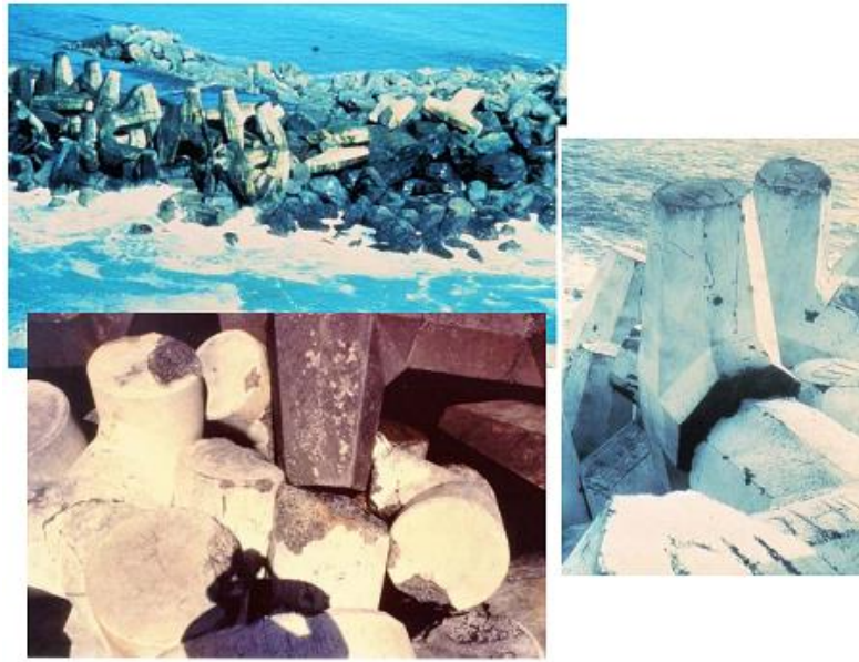
Hình 1.23 Minh họa sự nứt vỡ của các khối phủ bê tông [1]
