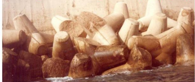
Hình 1.8 Hư hỏng của Đê chắn sóng Arzew El-Djedid (Algeria) [1]
