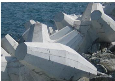
Hư hỏng của cấu kiện Core-Loc
