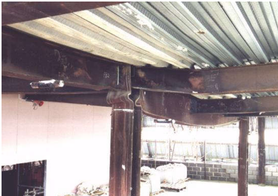
Hình 3. 42 Biến dạng trong khung sau thí nghiệm đốt cháy [31]
